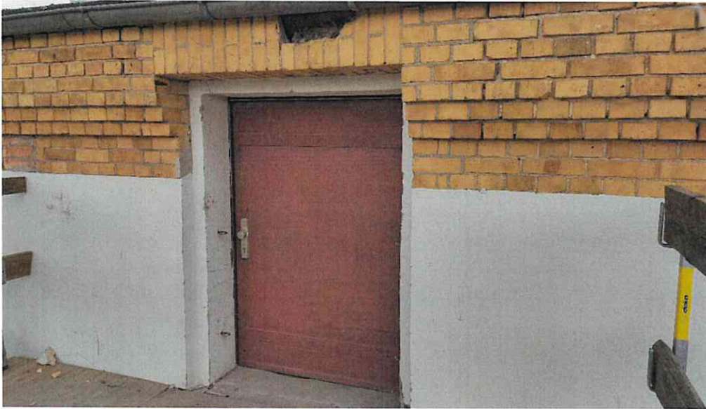
Bestehende Öffnung im Dachgeschoss von der Bautreppe aus
