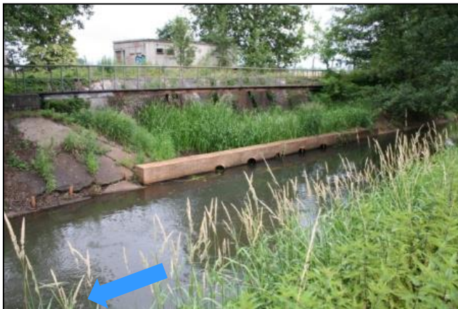
Beregnungs- und Pumpstation
